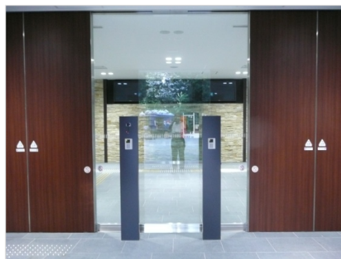
<風除室内カードリーダー>
