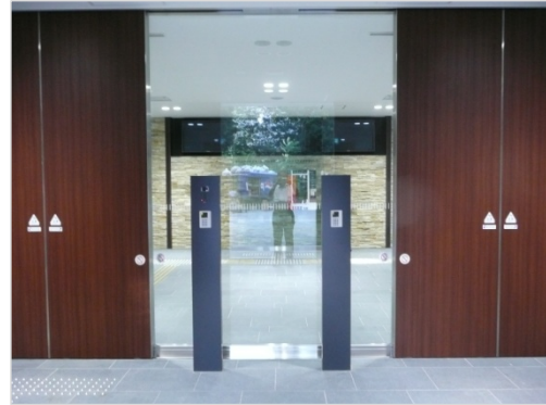
<風除室内カードリーダー>
